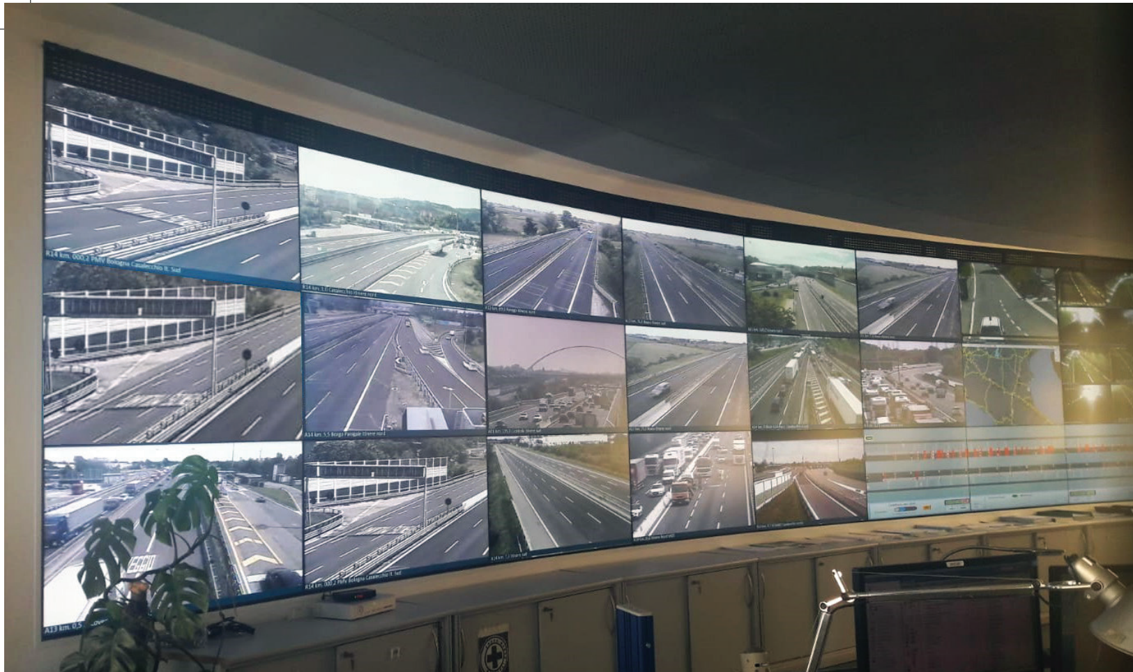
Sala di controllo di Bologna, Direzione III Tronco
